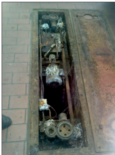
Vorhandene, verschlissene Hebebühne
