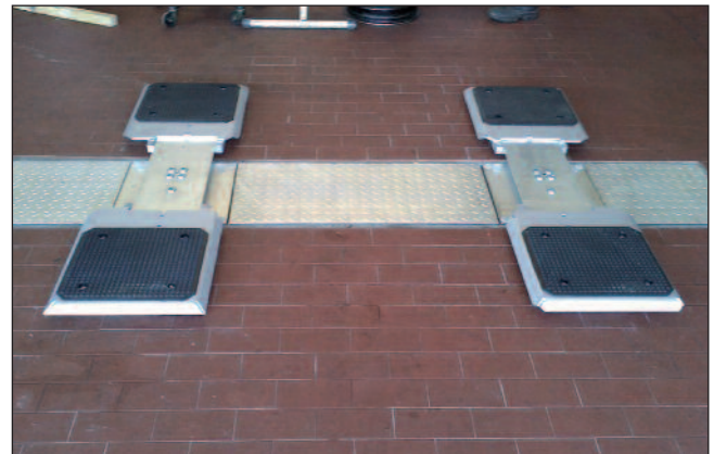
Neue Standard-Hebebühne fertig montiert.
